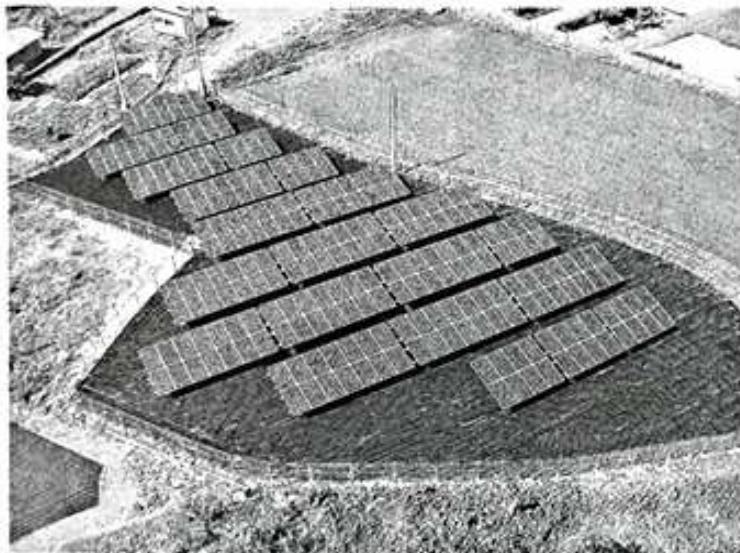
ALLアセットパートナーズが販売する安芸高田市の太陽光発電所
